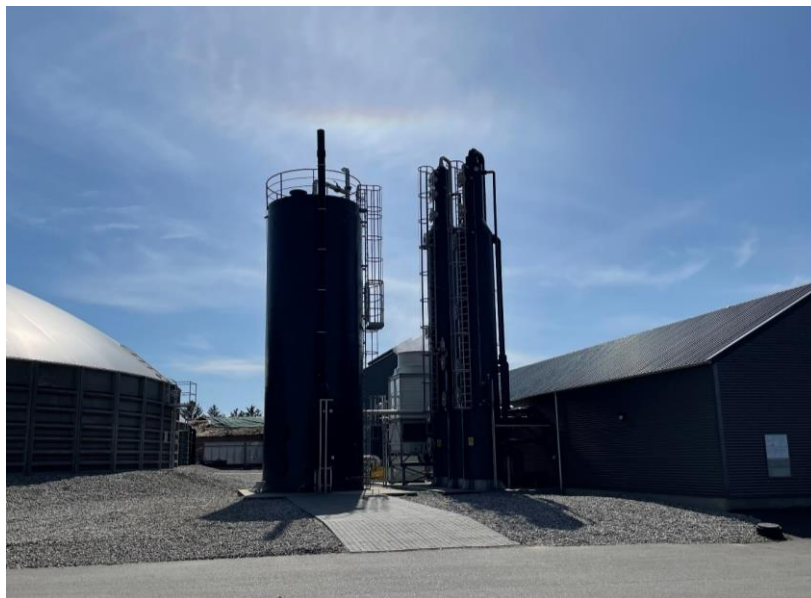
Bilde 6. Oppgraderingsanlegget. I en aminprosess blir rå-biogass oppgradert: metan skilles fra \text{CO}_2 og \text{H}_2\text{S} . Svovel går tilbake i bioresten. \text{CO}_2 sendes ut pipen. Foto: Martin Knoop.
