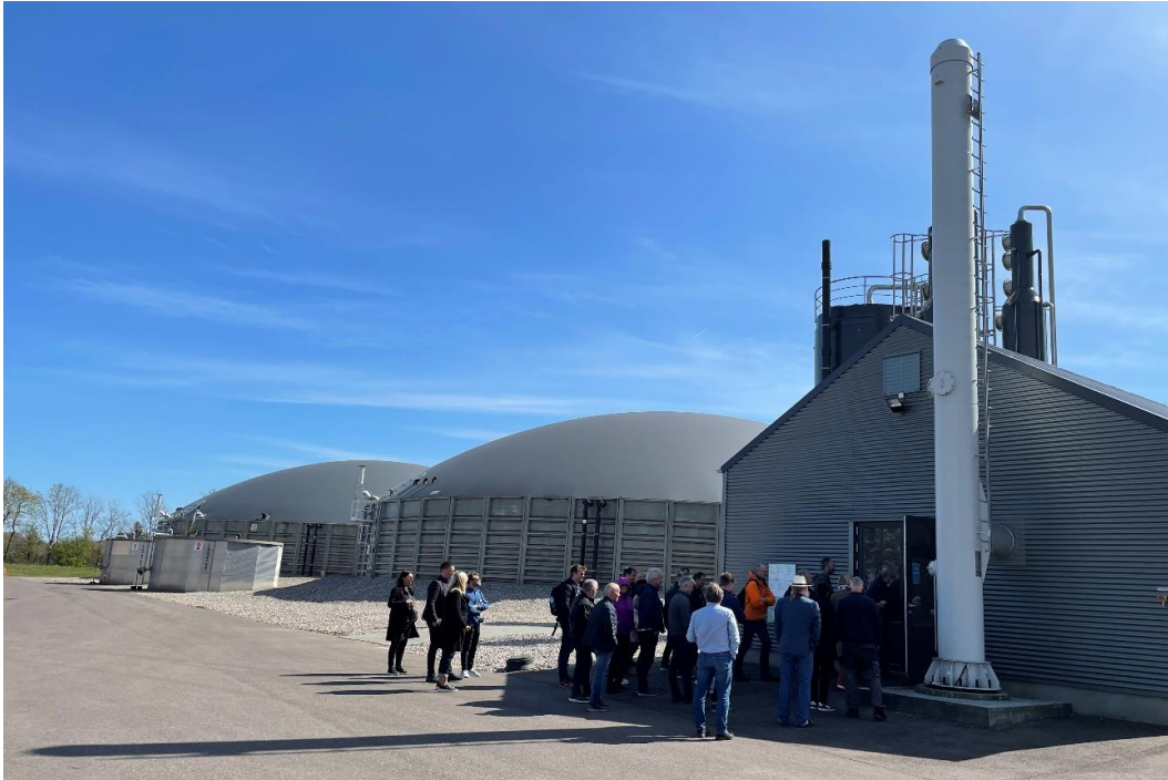
Bilde 7. Fyringsanlegget med skorstein. Det er en 2 MW gasskjele som går på naturgass. Gir 145 grader vann som går til oppgraderingen. Ikke damp, 6 bar trykk. Foto: Martin Knoop.
